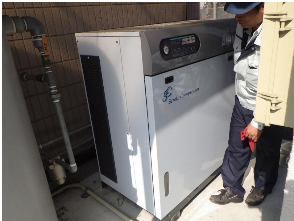
↑コンプレッサー
